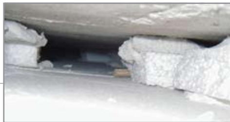
Pilt 3. Valesti liimitud SILS. Vahtpolüstüreenplaadid on liimitud vahtpolüstüreenplaadi tükkidele. Tulemuseks on fassaadikate, mis võib alla kukkuda.
