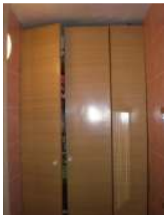
Joonis 5. 2 Väljatõmberest asub WC-sse paigaldatud kapi taga
